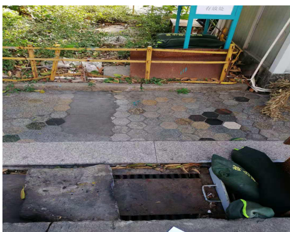
雨水总排放口阀门 1
